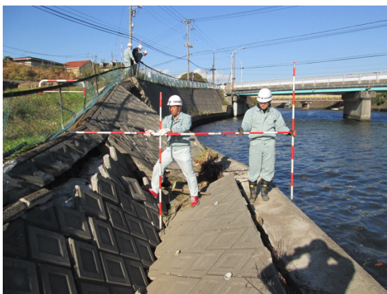
図 6 2013 年の台風による花見川護岸の崩落写真
